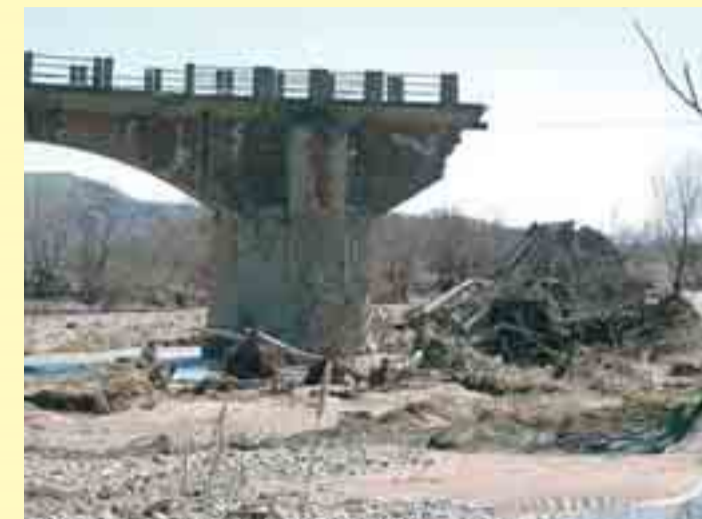
Collasso di un ponte stradale in località Ferrandina Scalo
